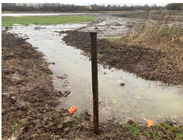
Figur 16: Eksempel på drænledninger omlagt til udløb i stenkiste med fordelerkile. Afstrømningsretningen er angivet med stippet blå pil.
