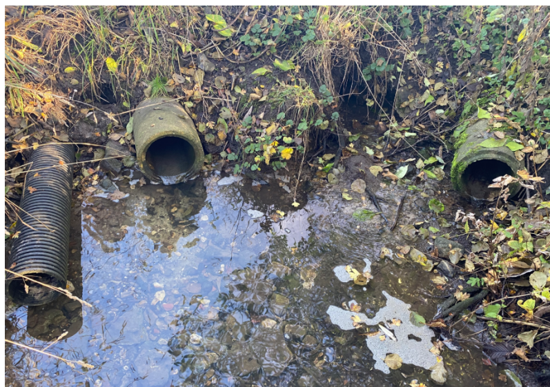
Figur 22: Tre lokaliserede drænudløb i grøft på matr.nr. 14b, Skyum By, Skyum.
