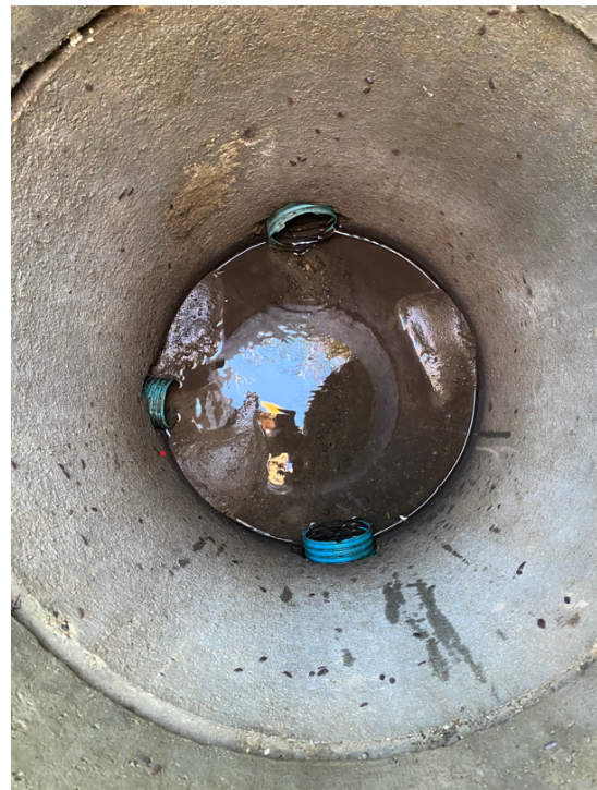
Figur 32: Øverst beliggende brønd med hhv. 2 indløb og et udløb. Udløbskote er indmålt til kote 1,43 m.
